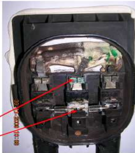
Spalt in der Deckeldichtung
